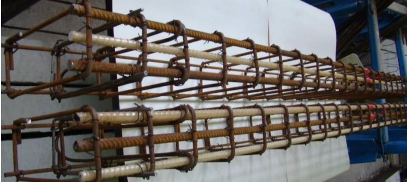
الشكل (4): شكل هياكل التسليح للجوائز البيتونية المسلحة بشكل هجين (بثلاثة قضبان 2 زجاجية GFRP و 1 فولاذي) أو (بثلاثة قضبان 1 زجاجي GFRP و 2 فولاذية) وهي بوضعية مقلوبة.
